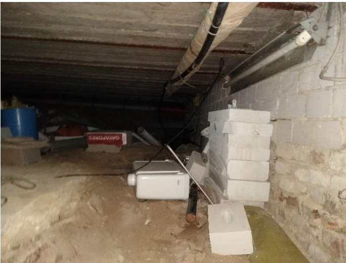
Abbildung 13: Kriechkeller unterhalb des Anbaus mit Haus- und Sperrmüll (westlicher Gebäudeteil).
