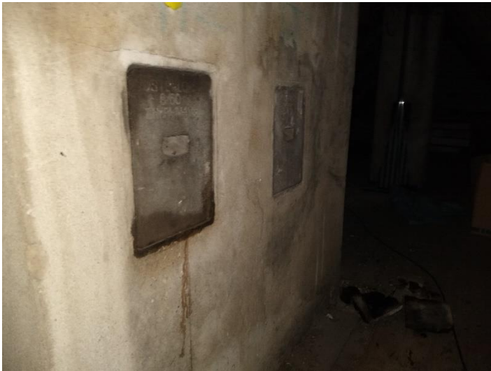
Abbildung 31: Wartungsklappen im Kamin.
