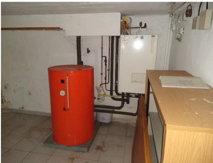
Abbildung 17: Gasheizung im Keller aus dem Jahr 1997.
